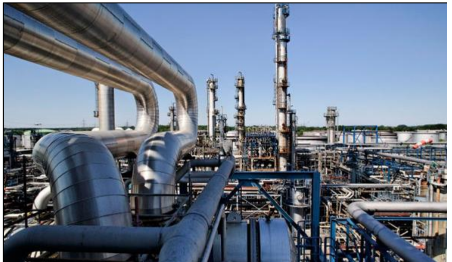
Die MiRO - Mineraloelraffinerie Oberrhein in Karlsruhe - ist Deutschlands größte Kraftstoffraffinerie und eine der modernsten und leistungsfähigsten Raffinerien in Europa. Für den Südwesten Deutschlands ist es die wichtigste Versorgungsquelle für Mineralölprodukte (Foto Homepage http://www.miro-ka.de )
